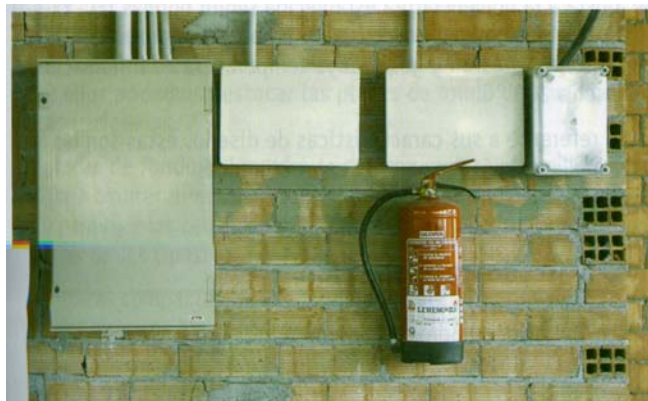
Imagen de cuadros eléctricos sobre mural
